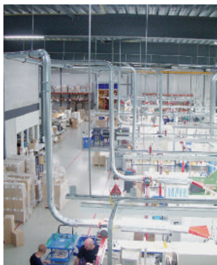
Die zentrale Absauganlage, die mit jeder Maschine verbunden ist, sorgt für eine effiziente Entfernung des Restmaterials
